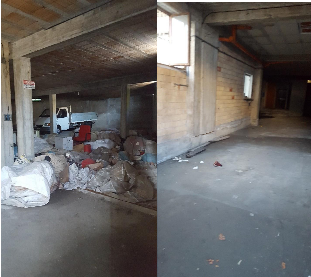
Locale completamente al grezzo con infissi manomessi
